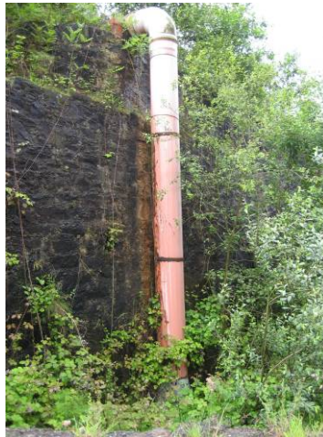
Fotografía 11-2.-Tubería de vertido del Pozo Tres Amigos
